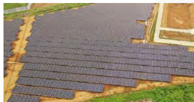
平川町D太陽光発電所
